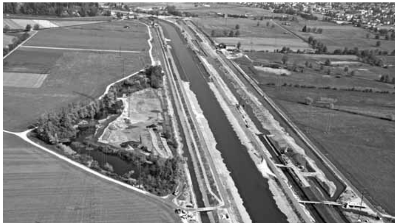
Bauarbeiten in vollem Gang: Im nächsten Jahr sollen die Bauarbeiten – hier eine Aufnahme davon aus dem Jahr 2011 – komplett abgeschlossen werden können.
